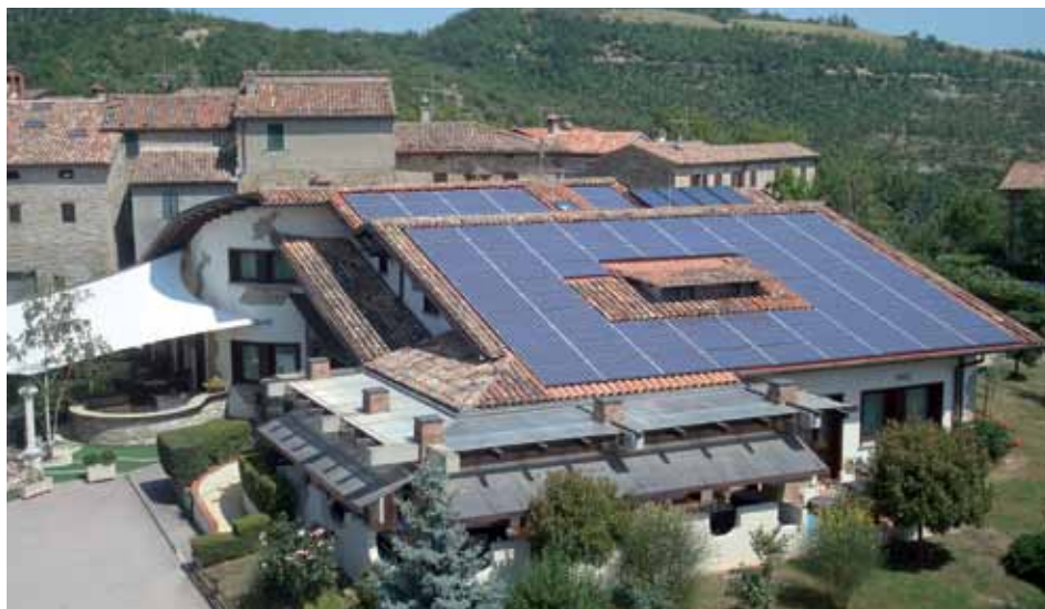
IMPIANTO FOTOVOLTAICO DA 19,80 KWP REALIZZATO A CITTÀ DI CASTELLO (PG)
