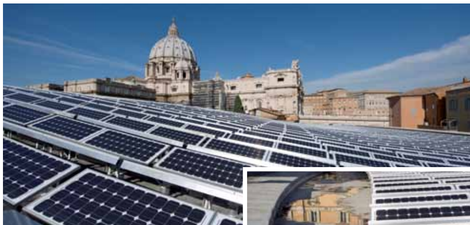
LA COPERTURA ORIGINALE IN CALCESTRUZZO DELL'AULA PAOLO VI È STATA SOSTITUITA NEL 2008 DA UN IMPIANTO FOTOVOLTAICO DA 221,59 KWP
