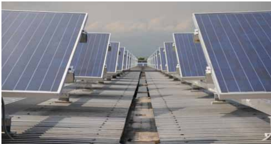
LE STRUTTURE SU TETTO CON POTENZA NON SUPERIORE A 1.000 KW SONO COMPRESSE NELLA CATEGORIA "PICCOLI IMPIANTI"
