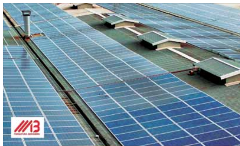
Impianto Industriale da 1 MWp Cividate Camuno (BS)
